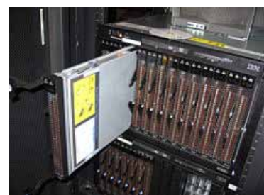
ブレードサーバ
