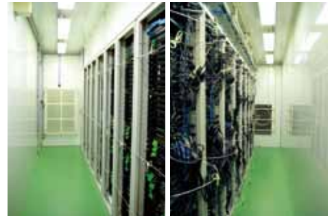
ITモジュールの内観。10KVAのラックが9台並ぶ。
