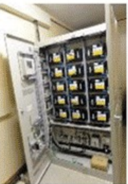
リチウムイオン蓄電池
