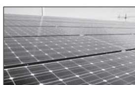
● 太陽光発電システム
