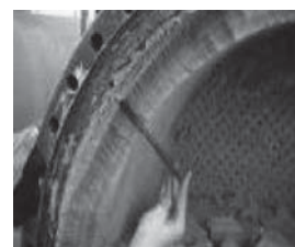
熱交換器の詰まり
