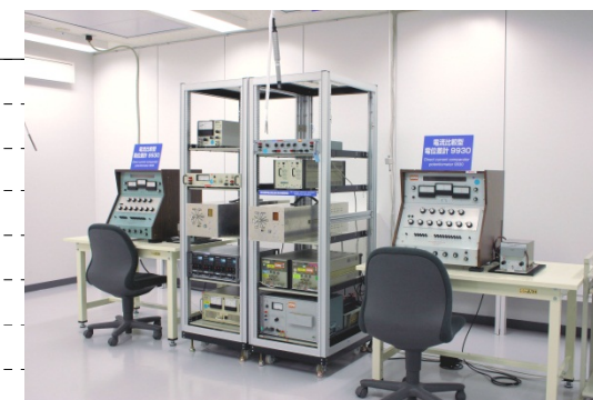
標準電圧システム(横河電機)
