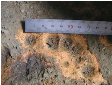
図4.9.1 実際の孔食(配管内面より撮影)
